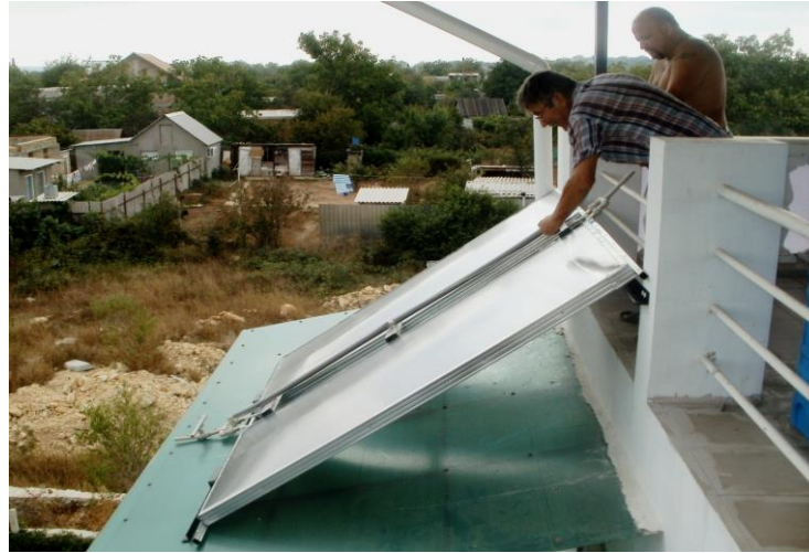
Р и с. 5. Солнечная установка для частного дома в г. Севастополе. Площадь гелиоколлекторов 4 м 2 . Производительность 300 – 350 л в день
