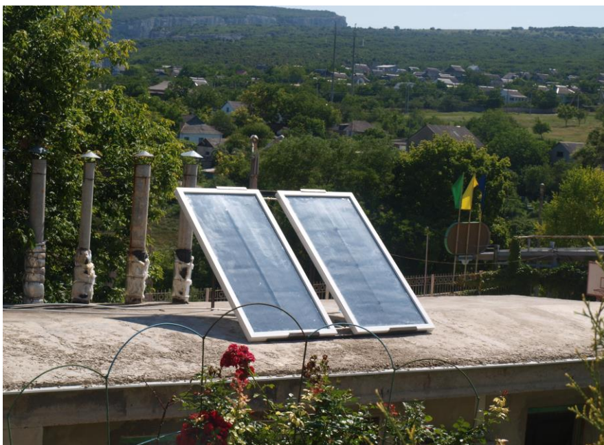
Р и с. 4. Солнечная установка на базе отдыха «Привал», г. Бахчисарай. Производительность 300 – 400 л горячей воды в день
